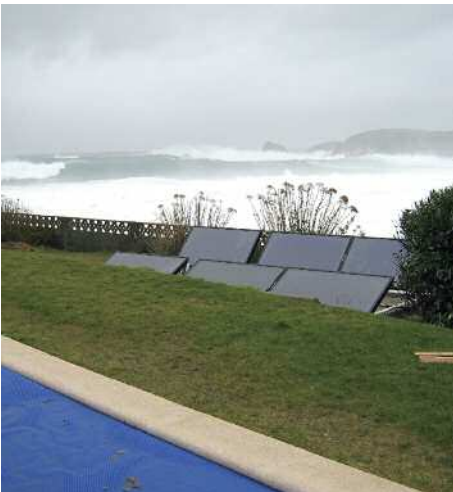
Instalação solar térmica de 12m 2 de superfície de captação para ACS, apoio ao aquecimento e climatização de piscina em Meirás (Valdoviño)
