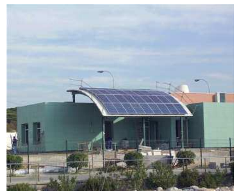
6,12 kW sobre coberta curvada no Ponto de informação do Parque Natural La Breña e Marismas em Barbate (Cádiz)
