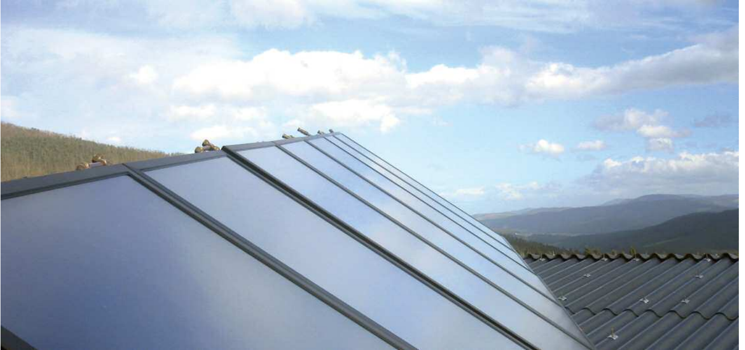
Instalação solar térmica de 32m 2 de superfície de captação para ACS em Ribadeo (Lugo)
