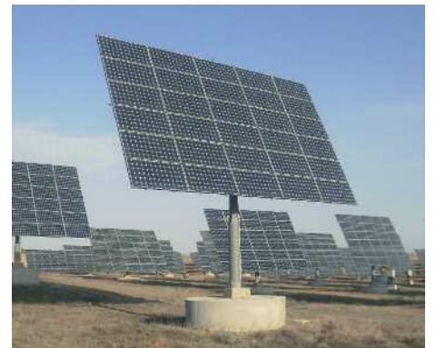
800 kW sobre seguidores em Villanueva do Duque (Córdoba)
