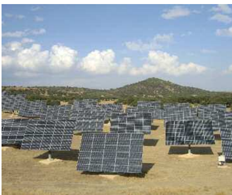
400 kW sobre seguidores de Alosno (Huelva)
