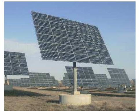
800 kW sobre seguidores en Villanueva del Duque (Córdoba)
