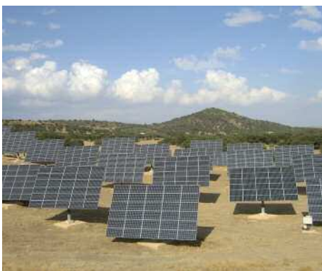
400 kW sobre seguidores de Alosno (Huelva)
