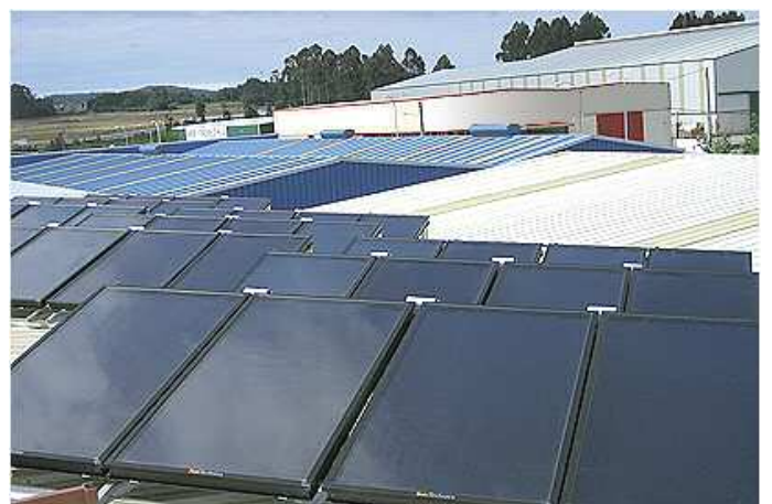
Instalación de 96m 2 de superficie de captación para climatización solar con máquinas de absorción en Narón (A Coruña)
