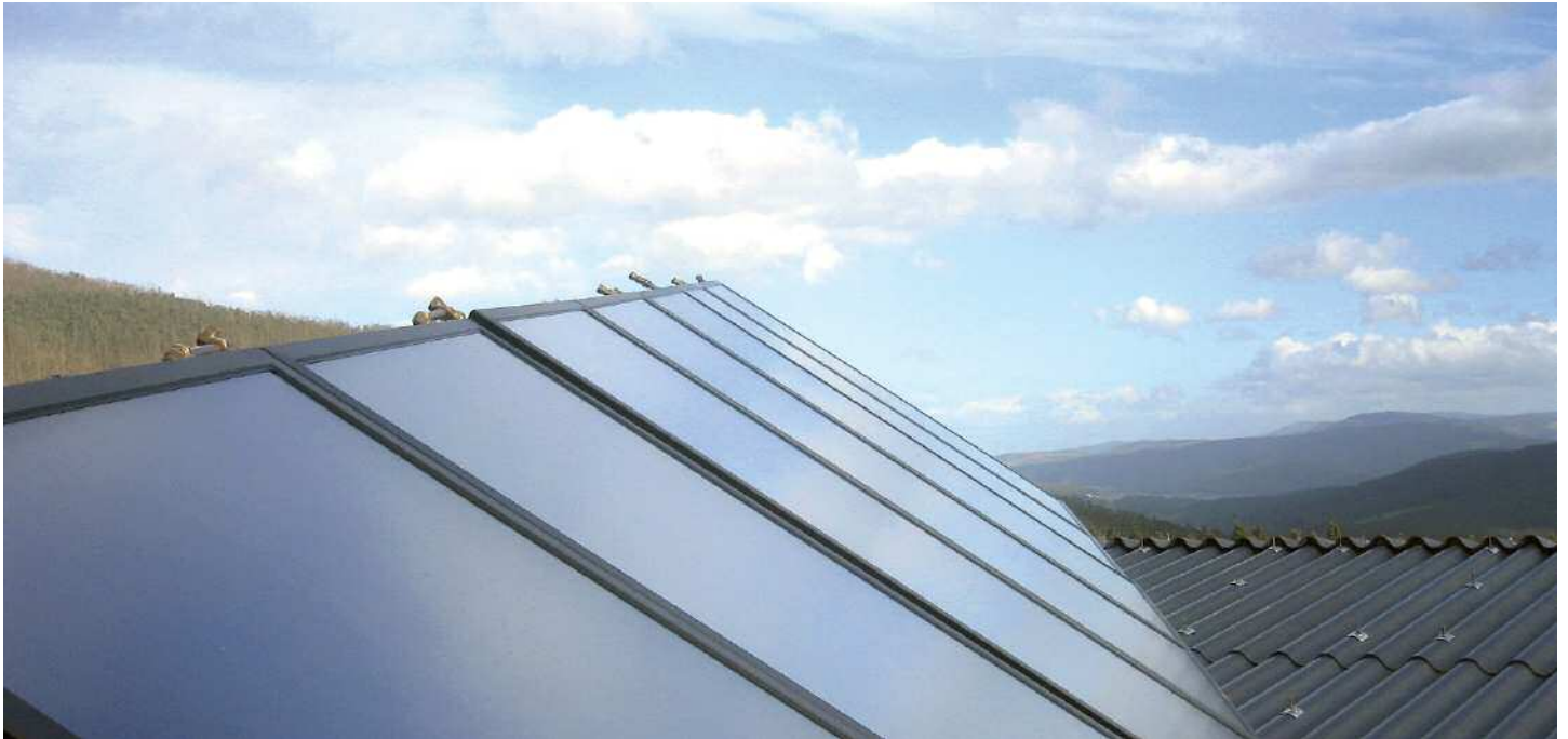
Instalación solar térmica de 32m 2 de superficie de captación para ACS en Ribadeo (Lugo)
