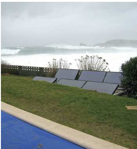
Instalación solar térmica de 12m 2 de superficie de captación para ACS, apoyo a calefacción y climatización de piscina en Meirás (Valdoviño)
